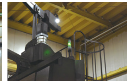
②積層信号灯が機械の稼働状況を表示
